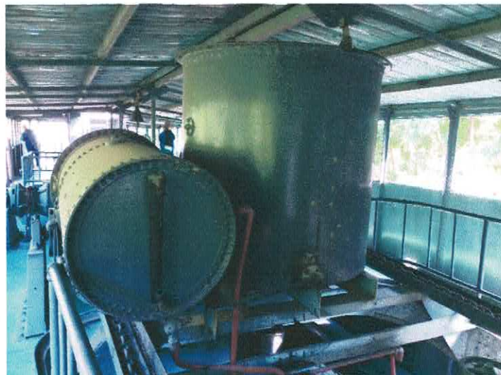
รูปที่ ๒๕ ถังน้ำมันเชื้อเพลิง
