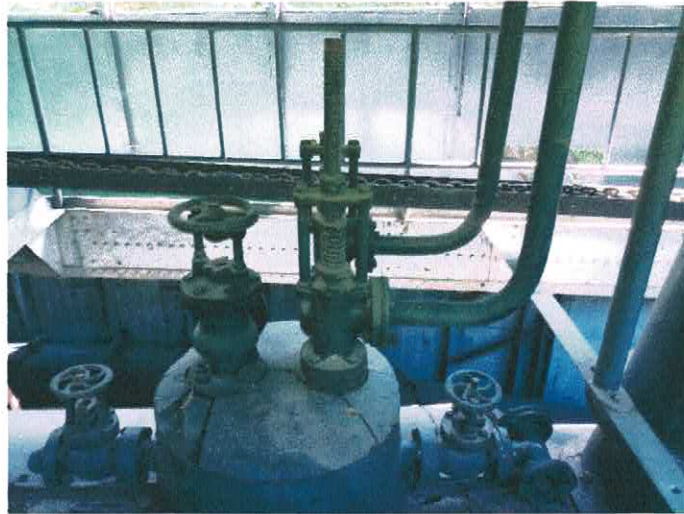
รูปที่ ๒๔ วาล์วลดแรงดันไอน้ำ (Release Valve)
