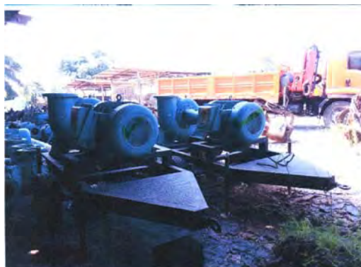
เครื่องสูบน้ำด้วยไฟฟ้าแบบเทอร์ลเลอร์ ๑๒ นิ้ว
