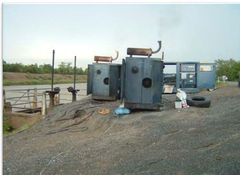
เครื่องกำเนิดไฟฟ้า ขนาด ๕๐ kW.
