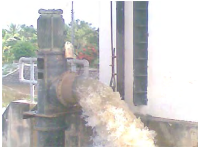
เครื่องสูบน้ำด้วยไฟฟ้า Vertical Pump ขนาด 0.5 \text{ m}^3/\text{sec} .
