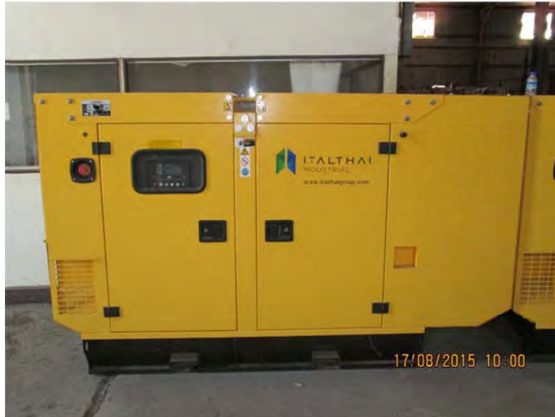
เครื่องกำเนิดไฟฟ้า ขนาด ๑๐๕ kW.
