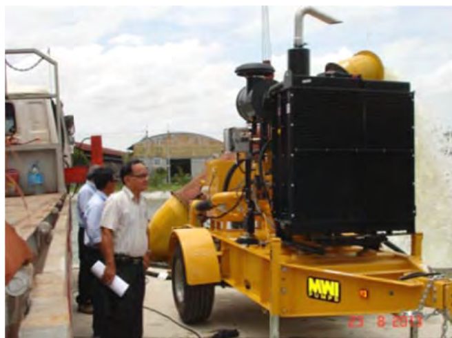
เครื่องสูบน้ำขับเคลื่อนด้วยระบบไฮดรอลิก ขนาด 2.0\text{ m}^3/\text{sec.} ( \varnothing ๓๐ นิ้ว)
