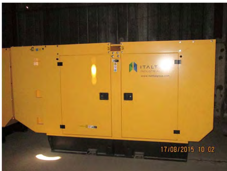
เครื่องกำเนิดไฟฟ้า ขนาด ๑๒๐ kW.
