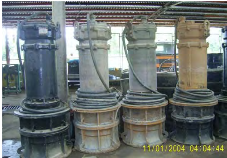
เครื่องสูบน้ำด้วยไฟฟ้า Submersible ขนาด 1.0\text{ m}^3/\text{sec} .
