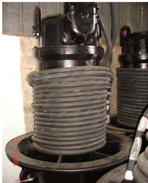
เครื่องสูบน้ำด้วยไฟฟ้า Submersible ขนาด 2.0\text{ m}^3/\text{sec} .
