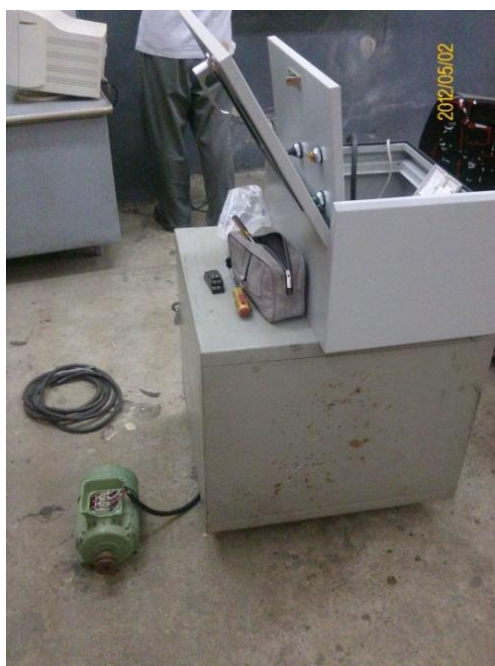
รูปที่ ๑๓ การทดสอบชุดควบคุมกับมอเตอร์ตัวเปล่า
