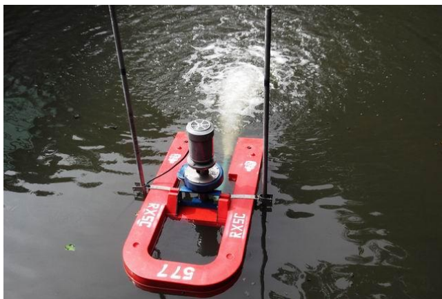
รูปที่ ๑๖ การทดสอบเดินเครื่องกลเติมอากาศหลังการติดตั้งชุดควบคุม
